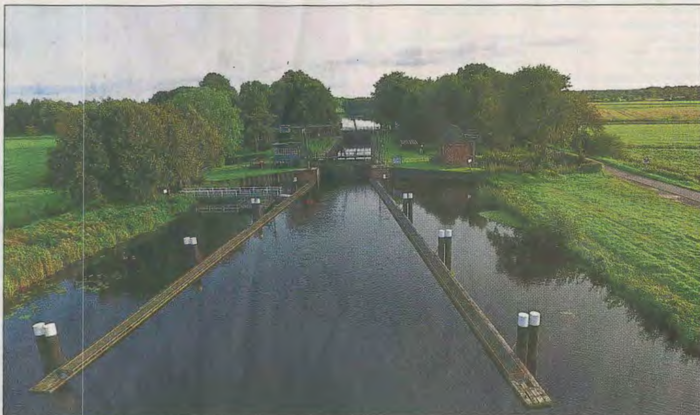
Die Gieselau-Schleuse ist in die Jahre gekommen. Eine regionale Initiative setzt sich für den Erhalt des maroden Bauwerks ein. Foto: Tiessen
